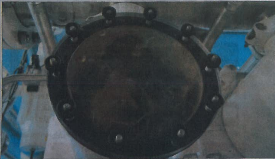
■ In de vergister van het Pharmafilter wordt het afvalwater bij hoge temperaturen met behulp van bacteriën gereinigd tot er geen aanwijsbare vervuiling meer in aanwezig is.
